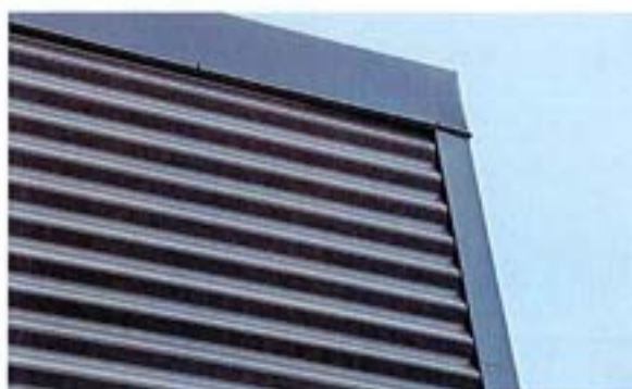
Bac acier ondulé interdit
