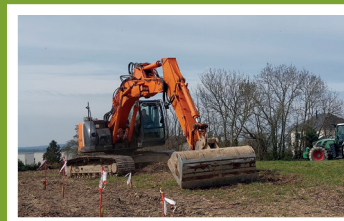
Début avril : Les travaux ont commencé pour l'aménagement de la ZAC Fontaine Fleurie/Ecanet.
